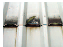
Alternativ lærpreget overflate på tak med vanlig varmforsinket stålunderlag etter 7 år.
